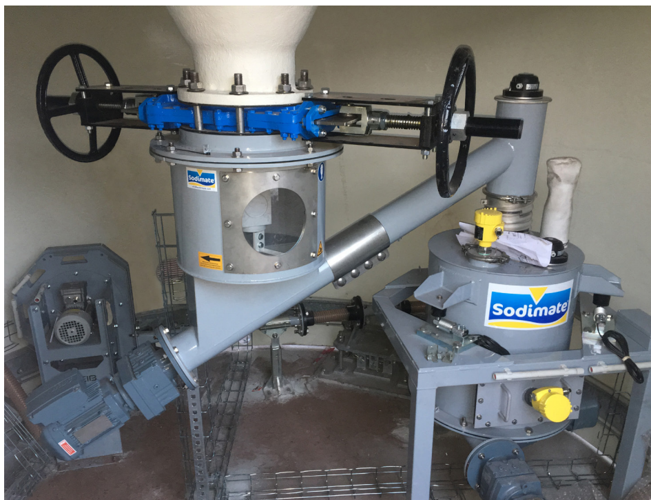
Sistema de dosificación gravimétrica
