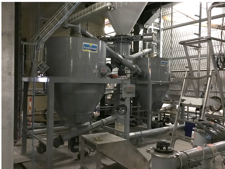
Tolvas pesadoras de Bicarbonato de sodio
